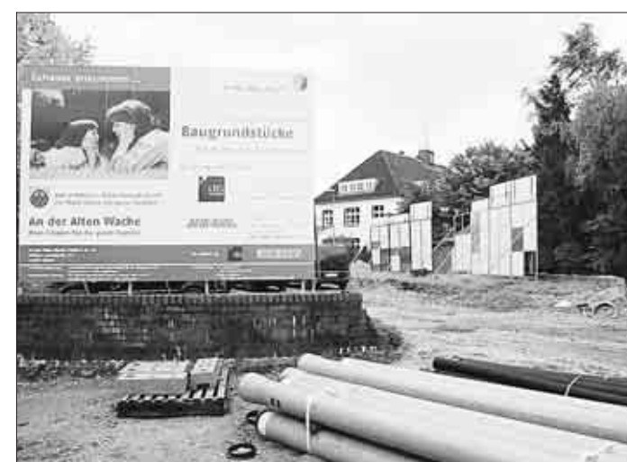
In der Mitte des Fotos hört die Mauer abrupt auf, am rechten Bildrand ist die zweite Hälfte zu sehen. Foto: Ahrent
